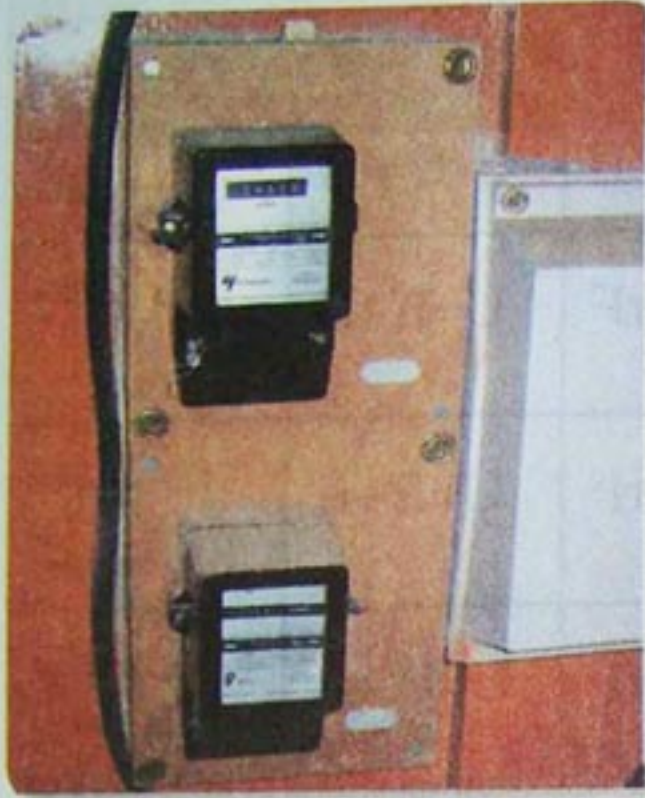
خزانة عدادات كهربائية من النوع الكهرومغناطيسي
