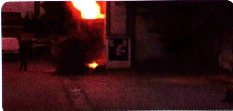
محول كهربائي يحترق
